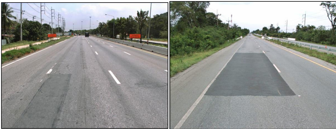
รูปที่ 1-125 ตัวอย่างสภาพผิวทาง 40 – 55 คะแนน Poor
